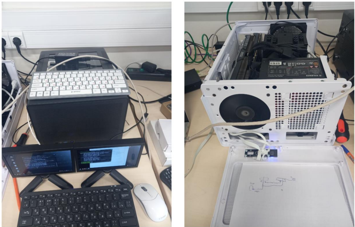
Рис. 30. Два сервера на периферии с GPU NVIDIA RTX 4080 — один кодировщик для восходящего канала, другой декодировщик для нисходящего канала — работают под Ubuntu 22.04 с CUDA 12 и PyTorch 2.3, подключены в линию между локальной сетью и GEO-модемом.
